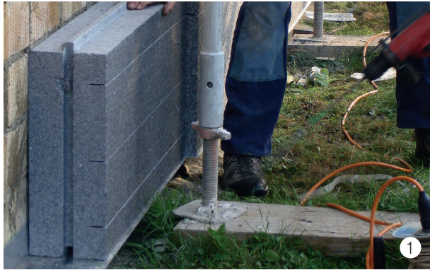
Pied de la façade sans isolation du socle.
