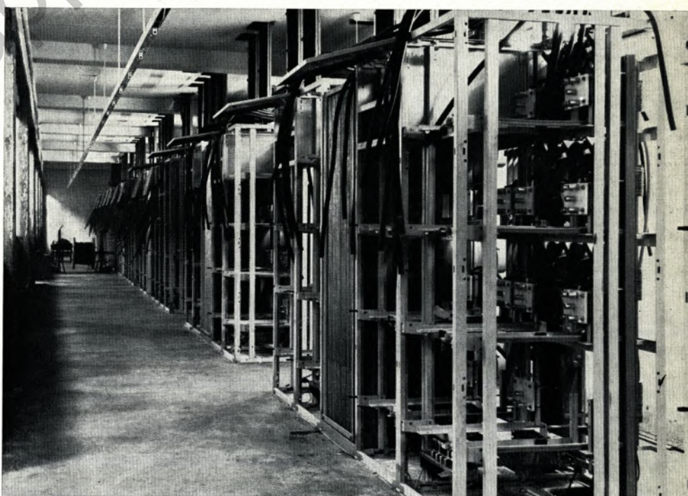
Dieses Bild zeigt die sogenannten Thyristor-Schränke im Elektrohaus, an denen gerade Kabelanschlußarbeiten ausgeführt werden
