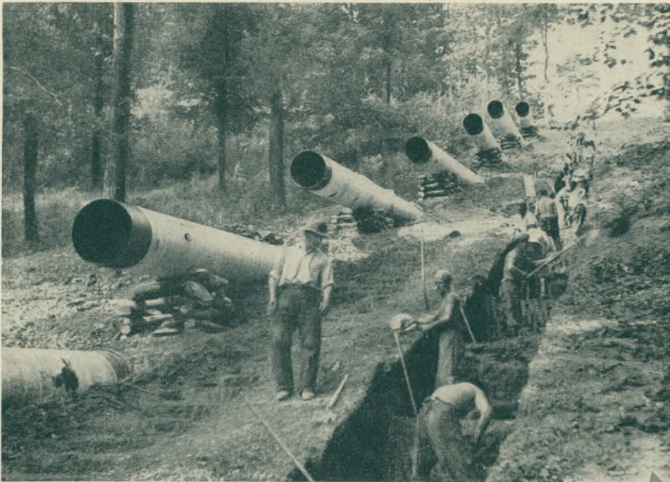
Beim Bau der 200 km langen Harzwasserleitung, der größten Fernwasserleitung Europas, zu der die Deutsche Röhrenwerke A.G. 50% der Röhre lieferte.
